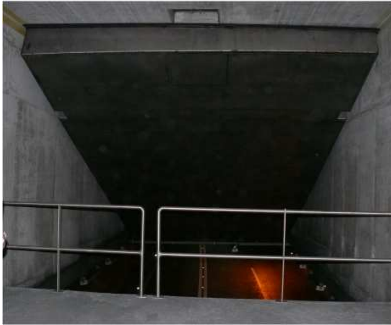
Abbildung 4.1 Geöffnete Abluftklappe vom Kanal aus gesehen
