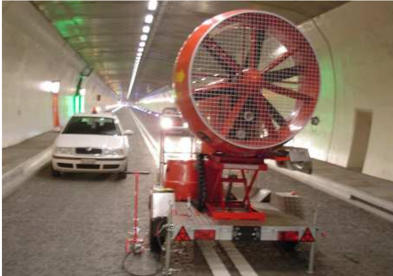
Abbildung 4.4 Mobiler Strahlventilator des Tiefbauamts Graubünden
